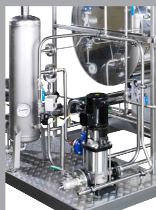
Druckerhöhungsanlage und Abschlammenspannungskühler
