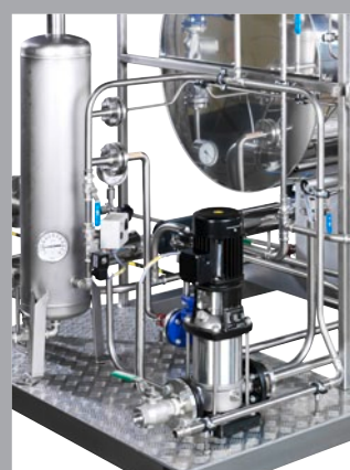
Druckerhöhungsanlage und Abschlammenspannungskühler
